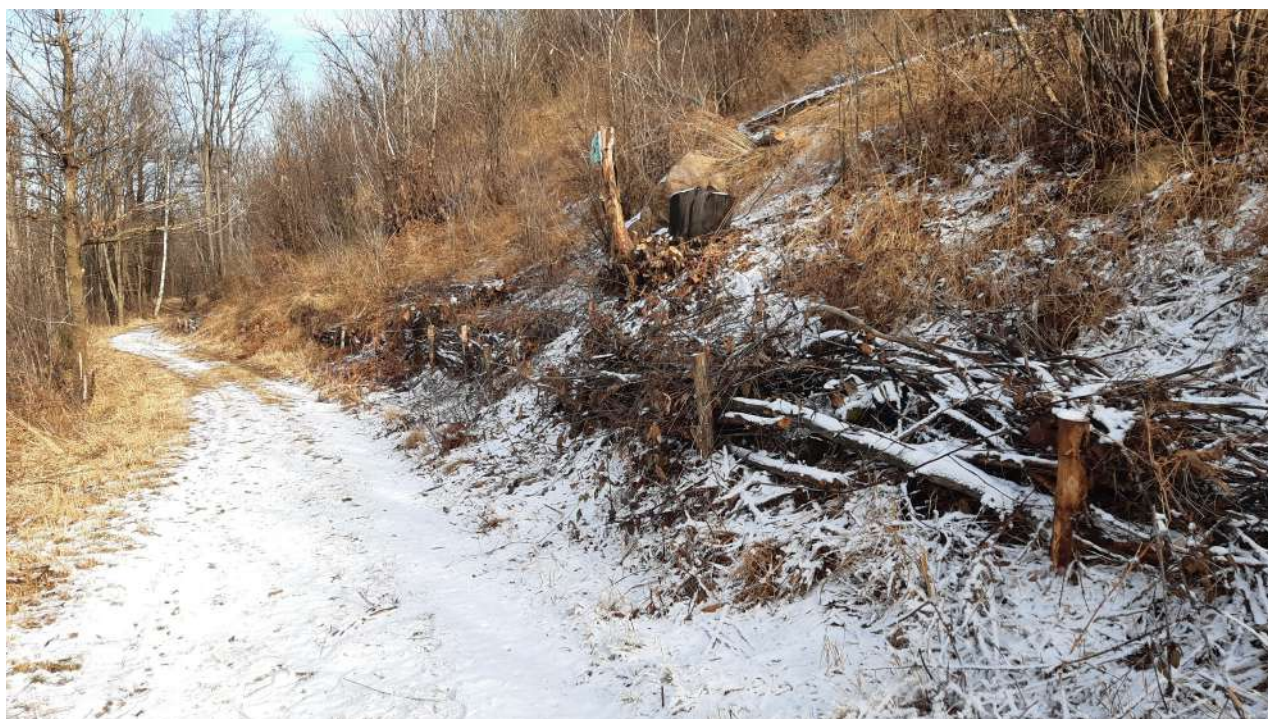
Sentiero 4, parte iniziale verso frazione Pemonte, intervento di abbattimento e riordino ramaglia mediante realizzazione di fascinate anti erosive.
